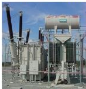
Transformador T2 da SE São Gonçalo do Pará
