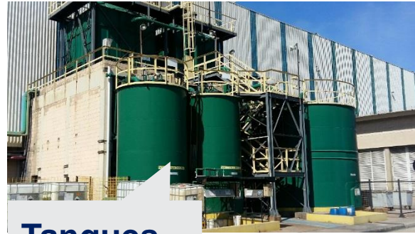
Tanques de Água
