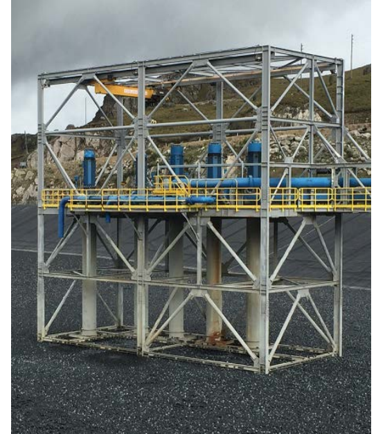
Bombeo de Solución Rica
