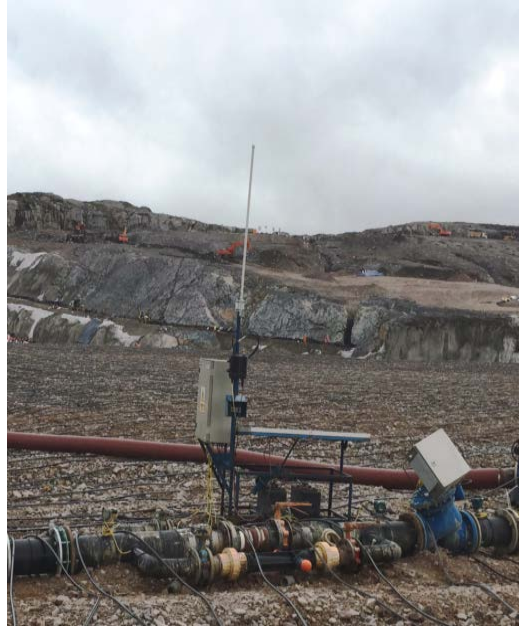
Riego de Celdas
